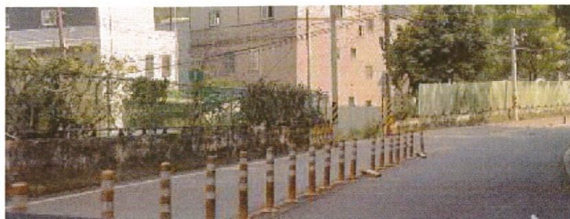
圖2 西勢湖路上損壞之交通桿-2
