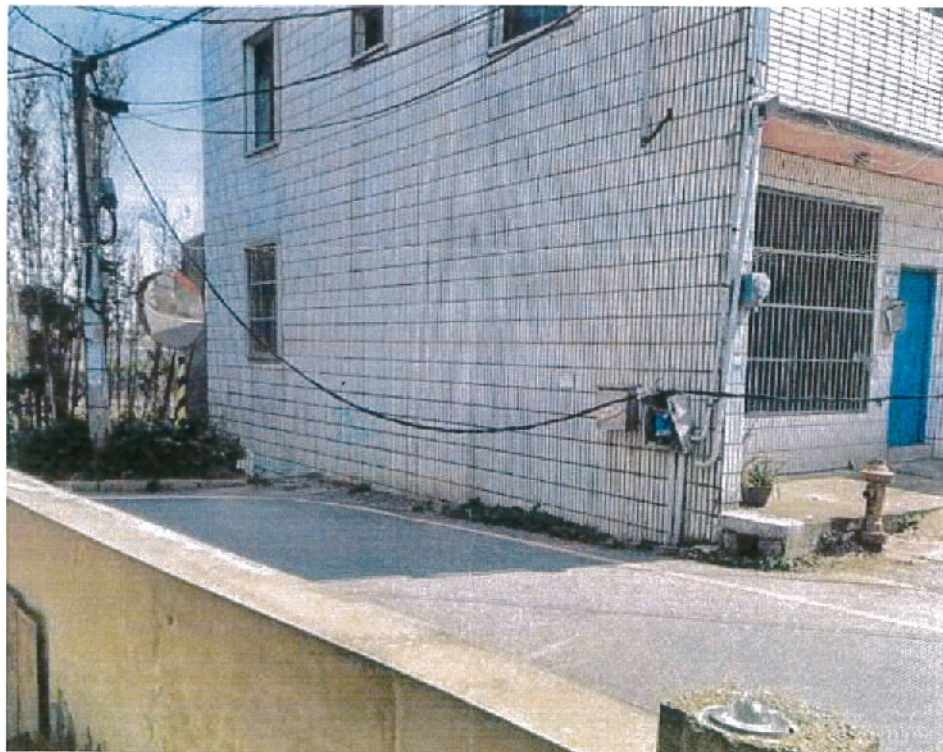
圖 1 嚴重電線掉落情形
