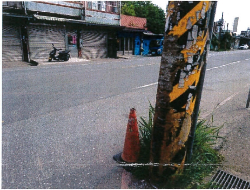
圖二、南竹路 3 段 98 巷電桿磨損情形
