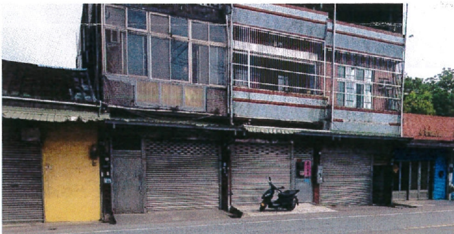
圖一、南竹路 3 段 98 巷口對面民宅雨遮碰損
